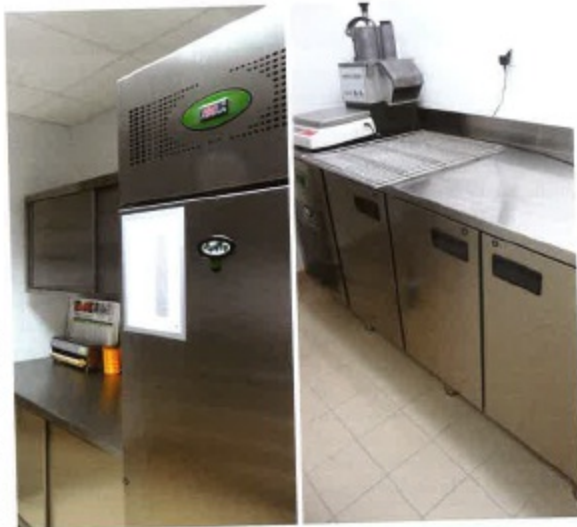
Des plans de travail tout inox réfrigérés sont installés dans la zone des préparations froides.
